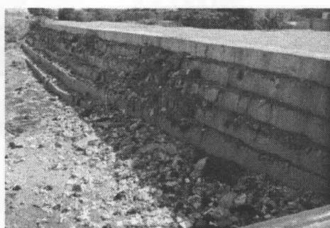
Punto crítico, margen izquierda río Ica, distrito de La Tinguiña, Junio - 2012
