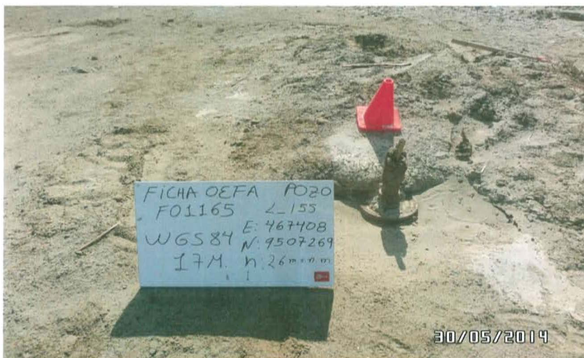
Fotografía N° 01.- Pozo con código PERUPETRO L_155 con Ficha OEFA F01165, se encuentra corroído con el casing enterrado y con cabezal compuesto de una brida y un arreglo de tuberías sin alguna válvula de cierre por lo que se encuentra expuesto al ambiente.
