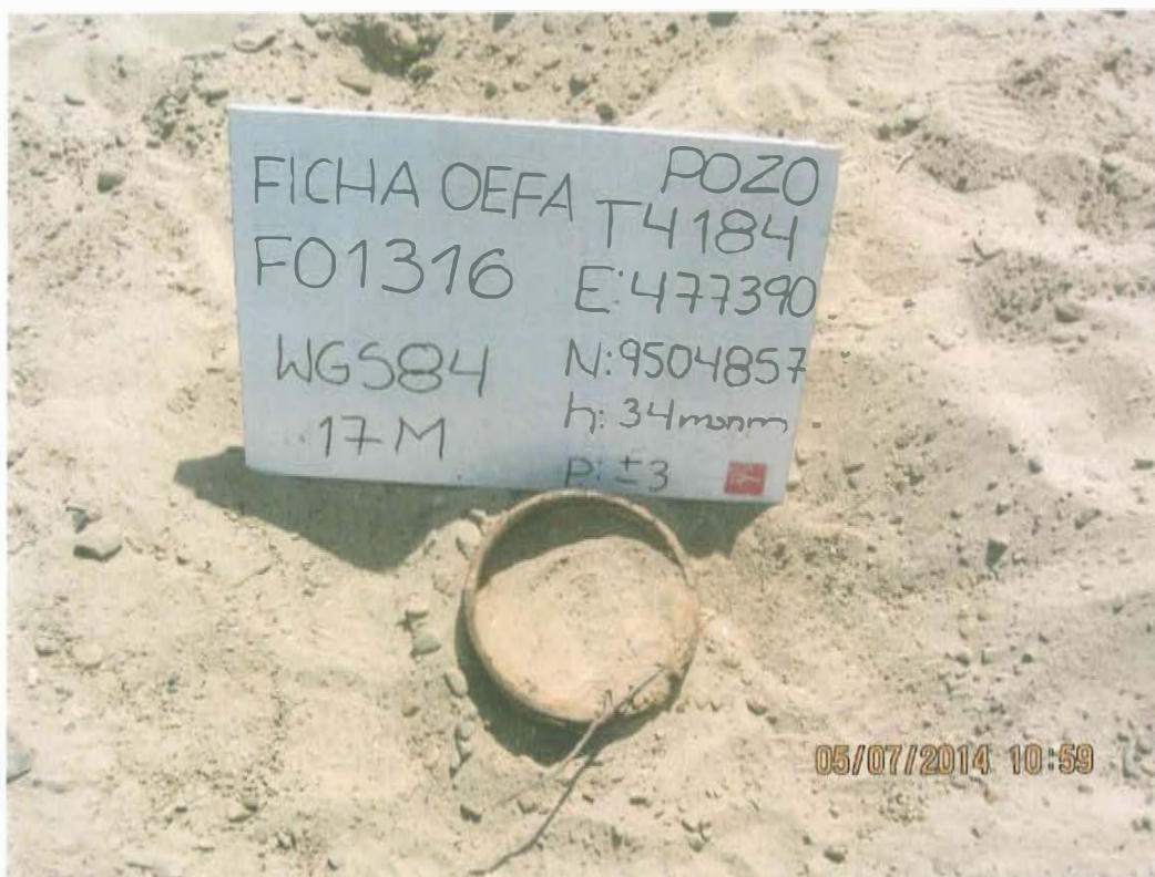
Fotografía N° 1. Se observa casing corroído con arena en su interior a nivel de la superficie del suelo.
