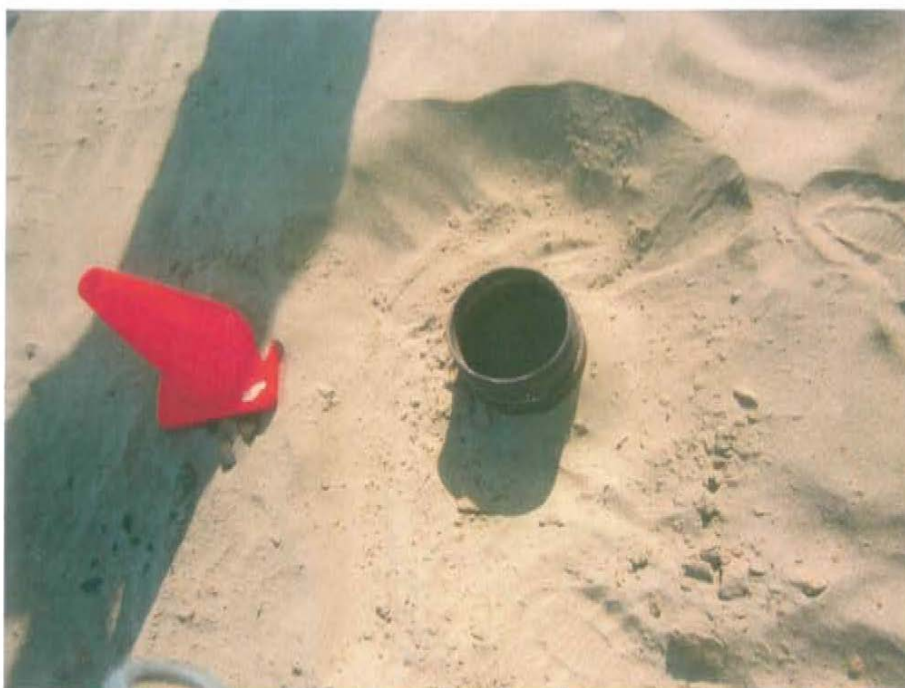
Fotografía N° 1. Vista de la ubicación del pozo donde se observa el casing sin brida ni válvulas, corroído y expuesto al ambiente.
