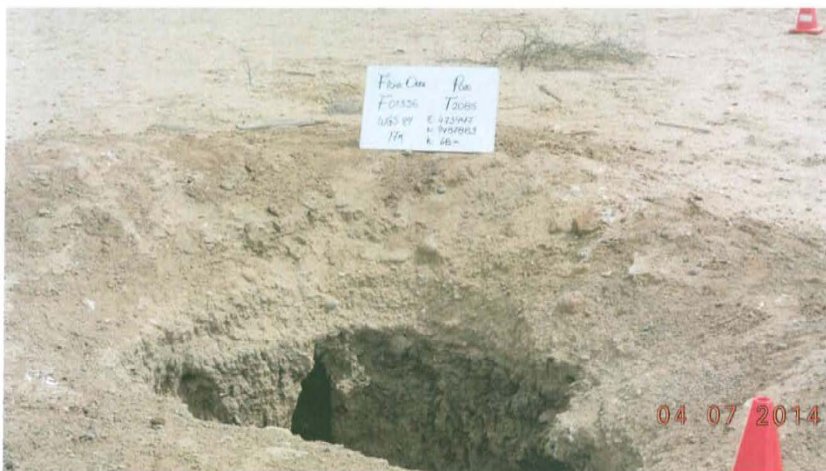
Fotografía N° 2. Se observa un hoyo de sección aproximadamente cuadrangular de 2 m de profundidad, dentro del cual se encuentra el pozo inactivo con casing al ras del suelo, abierto y expuesto al ambiente, sin accesorios que aseguren su hermetismo.
