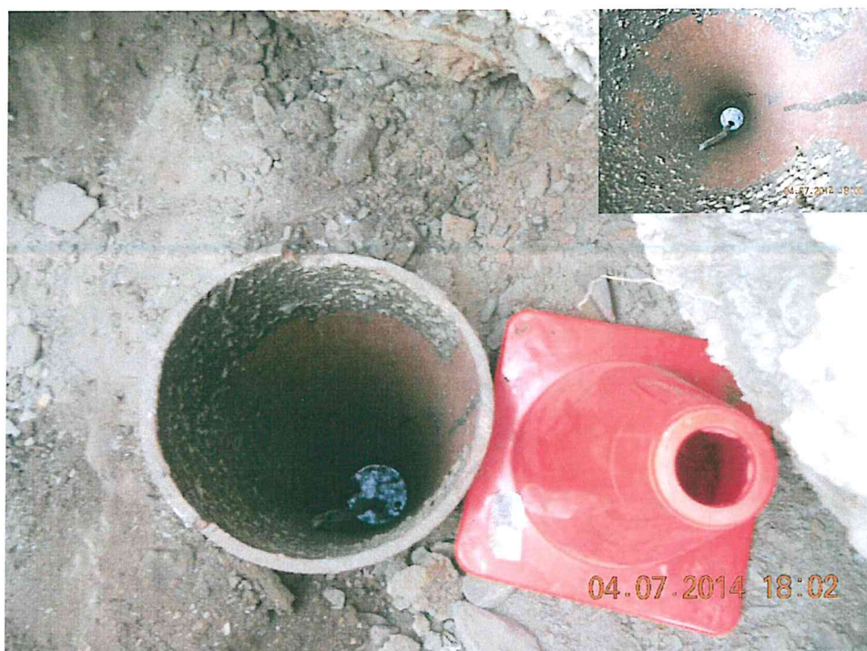
Fotografía N° 2. Pozo abierto al ambiente y cortado, sobresale 0,18 m del interior de un hoyo de 1,2 m de profundidad, en el interior se observa líquido de coloración verdosa (mezcla de hidrocarburos y agua).
