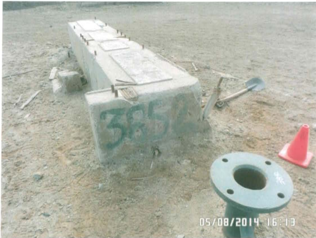
Fotografía N° 1. Vista pozo T3852 ubicado en una planicie con vía de acceso, se observa el casing expuesto al ambiente.
