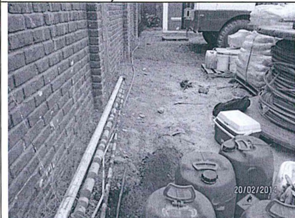
Fotografía N° 5. Suelo con evidencia de derrame de sustancias oleosas.
