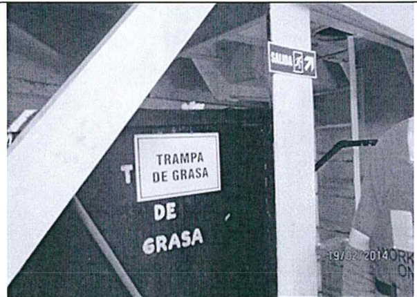
Fotografía N° 2. Trampa de grasas, instalado antes de la planta de tratamiento de agua, ubicado en la Barcaza BPZ 01.
