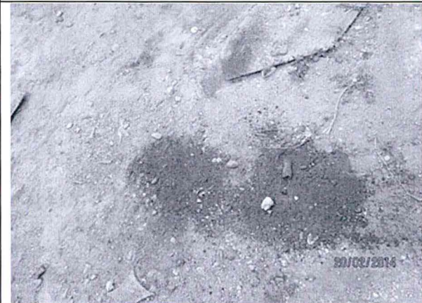
Fotografía N° 3. Suelo con evidencia de derrame de sustancias oleosas y metales oxidados.
