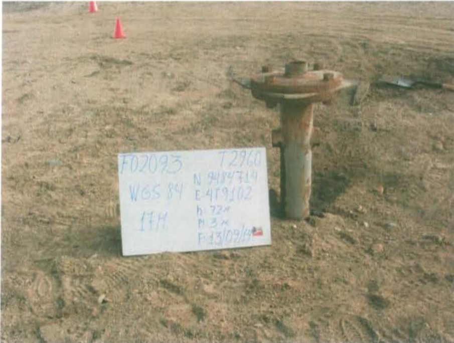
Fotografía N° 1. Vista de la ubicación del pozo donde se observa el casing con brida y válvula corroído expuesto al ambiente.
