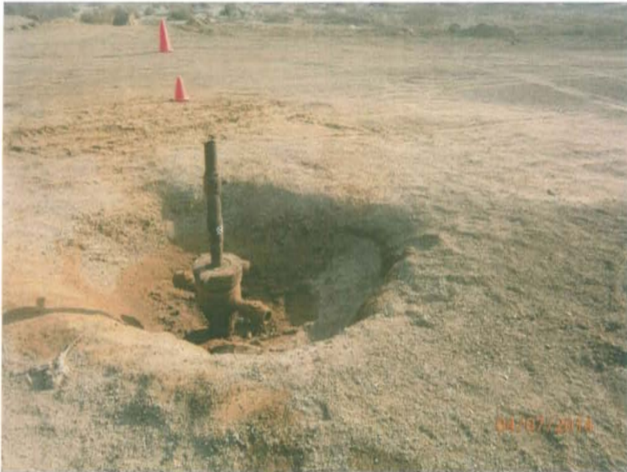
Fotografía N° 1. Vista de la ubicación del pozo inactivo expuesto al ambiente y en estado de corrosión.
