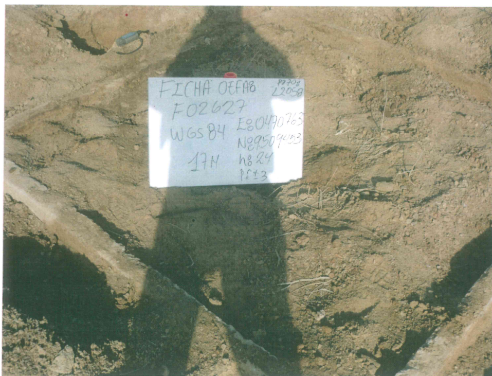
Fotografía N° 1. Pozo no ubicado, no se visualizó superficialmente el cabezal ni el casing del pozo; sin embargo, se observó una cantina de aproximadamente 2 m por 2 m de lado cubierto parcialmente con tierra.
