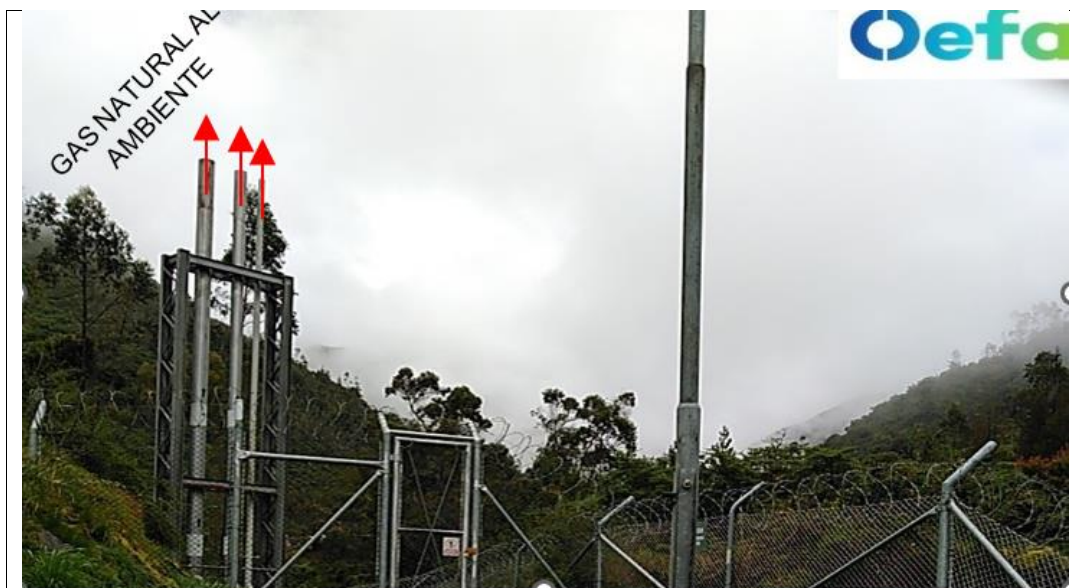
Imagen N° 4. Torre de descarga con tres (3) chimeneas de venteo sin evidencia de instalación de silenciadores Fuente: Registro fotográfico de las acciones de supervisión
