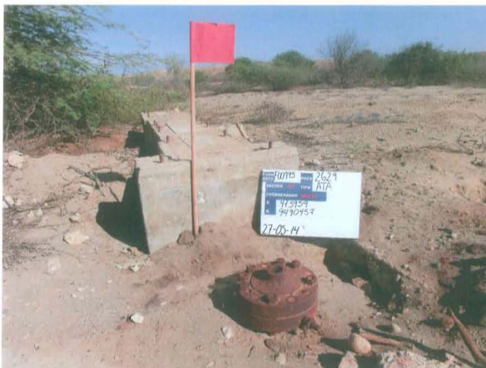
Fotografía N° 1. El Pozo T2629 presenta cabezal compuesto por una brida con dos salidas laterales, por donde de una de ellas se percibe emisiones gaseosas fugitivas.
