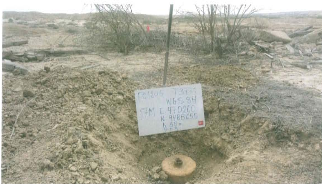
Fotografía N° 1. Pozo T3771, presenta casing con tubería de reducción abierto.
