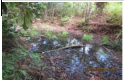
Poza generada por la tubería de drenaje que descarga fluidos de la Plataforma 02
