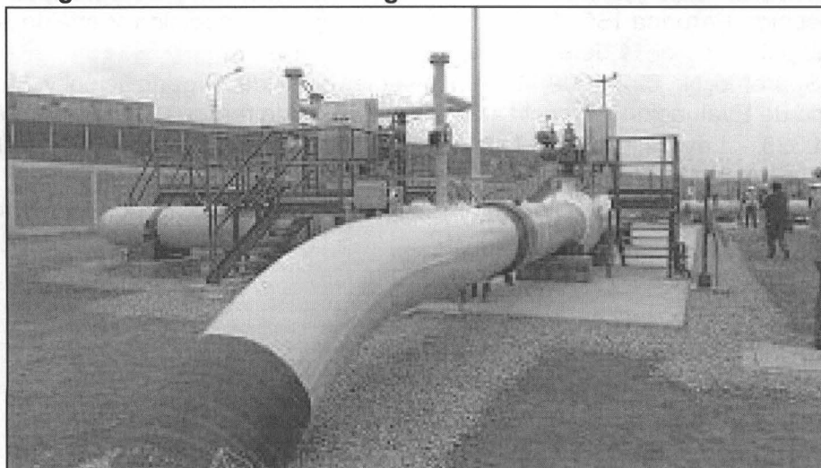
Imagen N° 02. Estación de Regulación de Presión - ERP de CALIDDA
