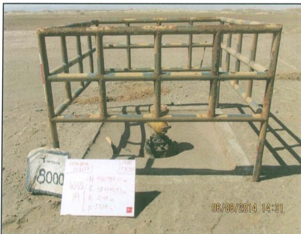
Fotografía N° 2. Cabezal del pozo T8000 compuesto por bridas y válvulas que emerge 0,35 m desde la superficie del suelo.
