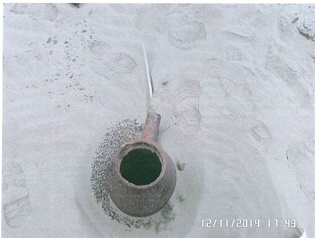
Fotografía N° 1. Vista del pozo T1618, se observa el casing abierto al ambiente.
