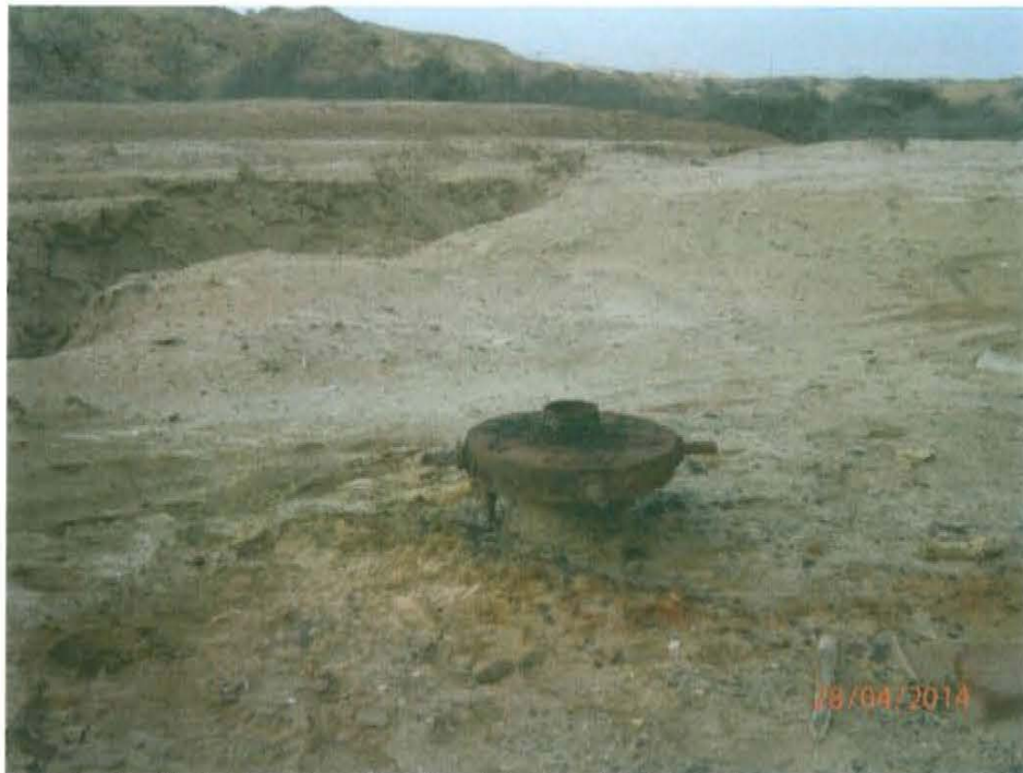
Fotografía N° 1. Vista de ubicación del pozo donde se observa el pozo con el casing y brida en estado de deterioro sobre la superficie del suelo.
