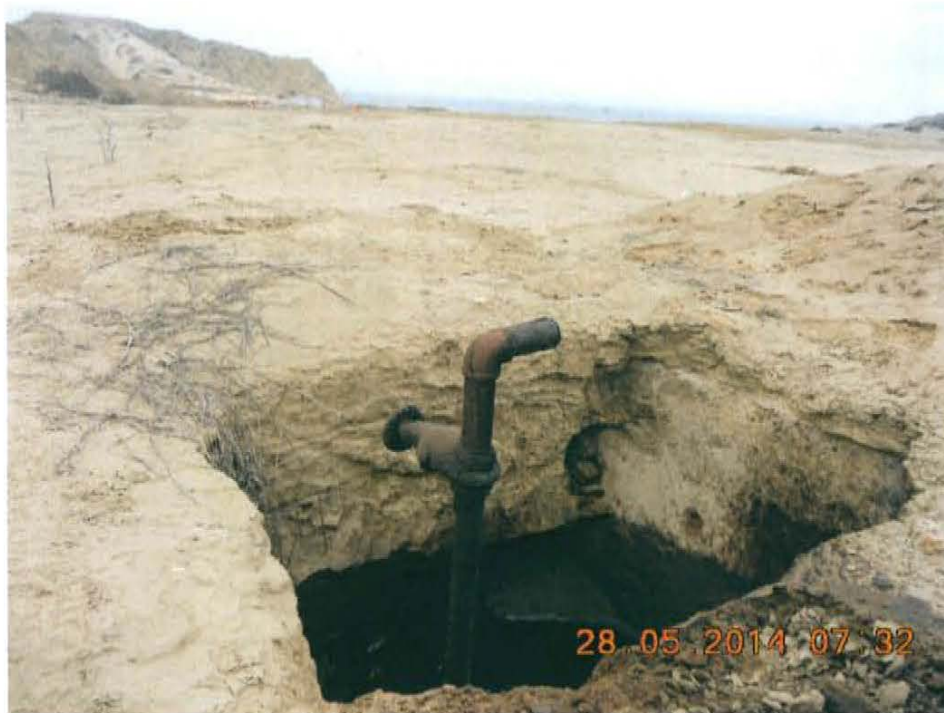
Fotografía N° 3. Se observa tubería de reducción de 5 plg de diámetro en estado corroído e impregnada con hidrocarburos en el interior de un hoyo de sección rectangular de 1,7 m 2 .
