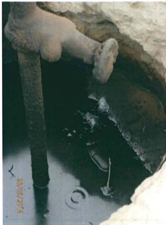
Fotografía N° 4. Se observa que la válvula de cierre se encuentra deteriorada, de la cual escapan hidrocarburos al interior del hoyo.
