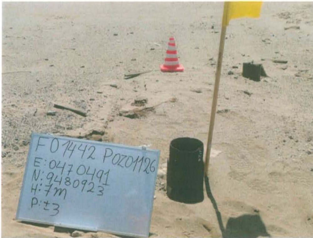
Fotografía N° 1. Pozo mal abandonado perteneciente a la ficha F01442 con avanzado estado de corrosión.
