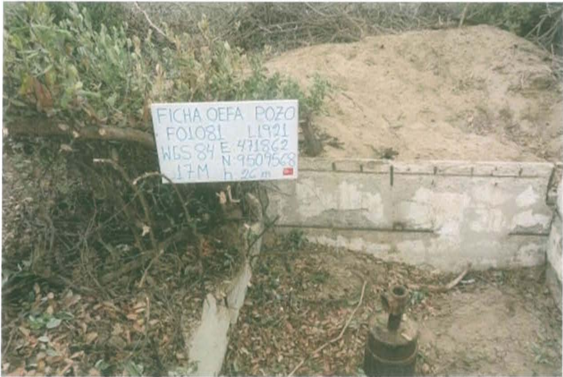
Fotografía N° 1. Identificación del pozo inactivo con código PERUPETRO L1921. Presenta casing con tubería de reducción corroído y abierto.
