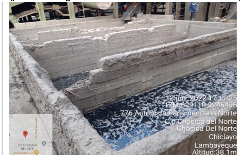
Imagen N.º 5: Fotografía del sistema de tratamiento de efluentes (2)
