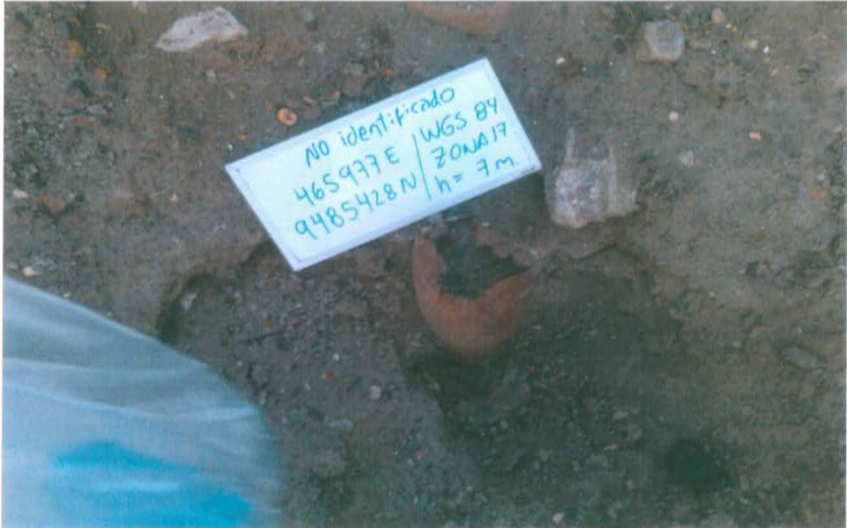
Fotografía N° 1. Se observa el Pozo con código Ficha OEFA F00210 con casing corroído y deteriorado, sobre una superficie pedregosa lleno en su interior de tierra.
