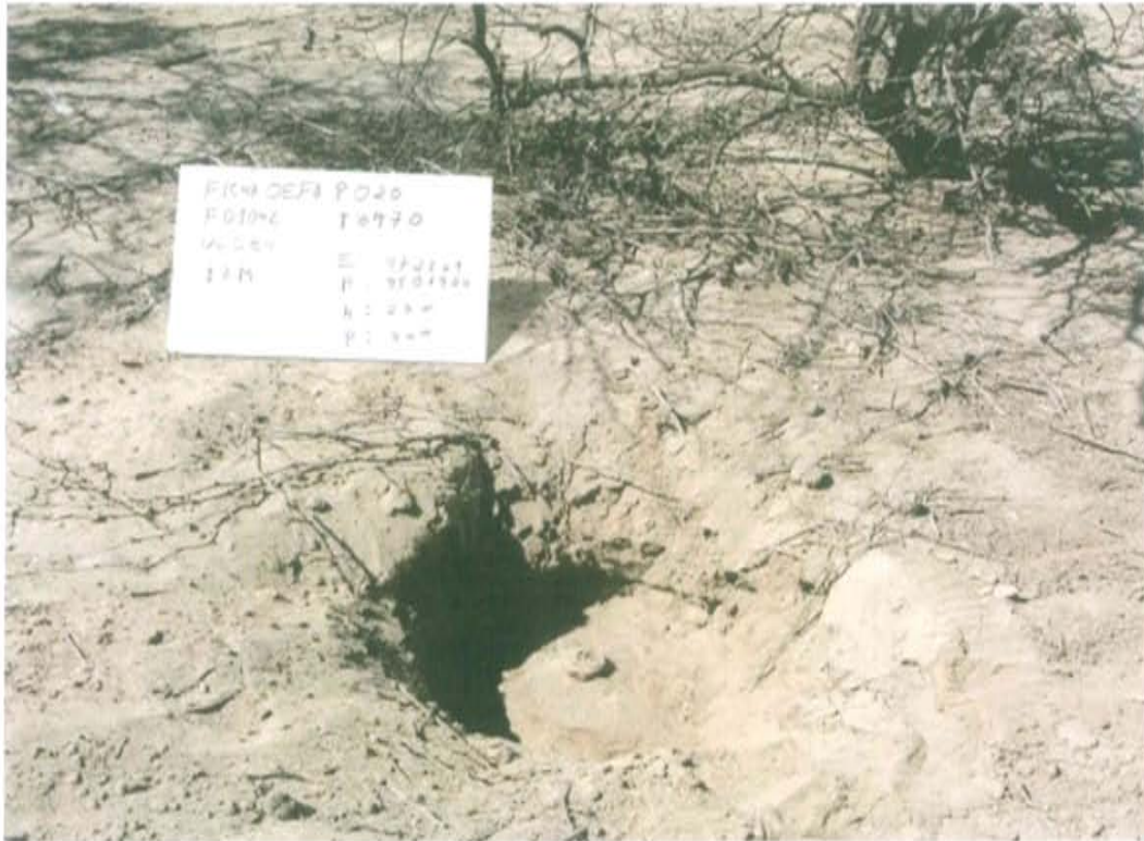
Fotografía N° 1. Identificación del pozo inactivo con código PERUPETRO T3970. Presenta casing corroído en el interior de una excavación y con tubería en la parte superior.
