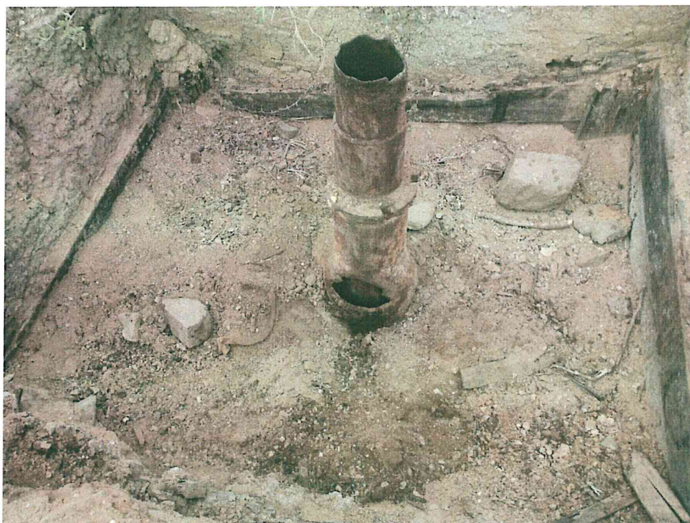
Fotografía N° 3. Presenta una abertura en la parte lateral del casing y sin elementos de cierre que aseguren su hermetismo por lo que se encuentra abierto.
