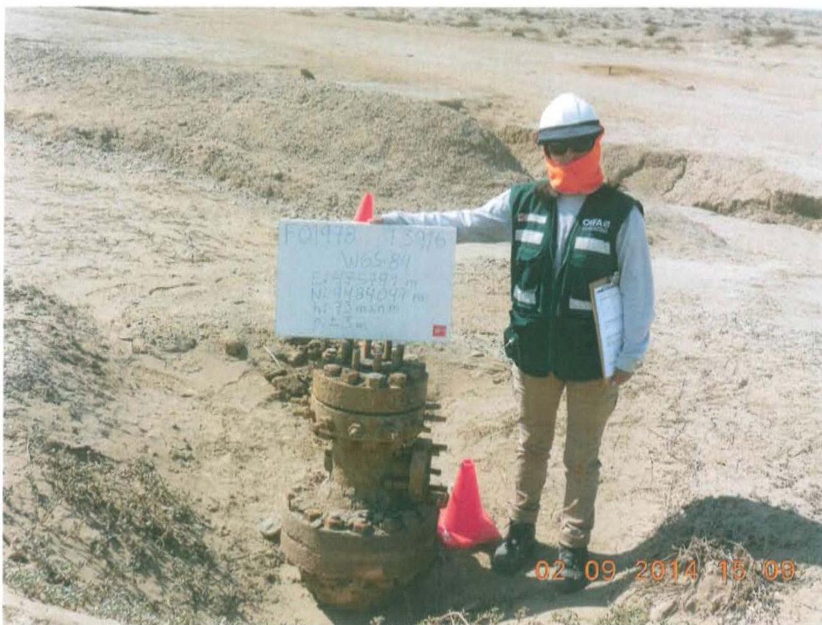
Fotografía N° 1. Pozo inactivo sin terraplén habilitado, se observa casing y brida corroído.
