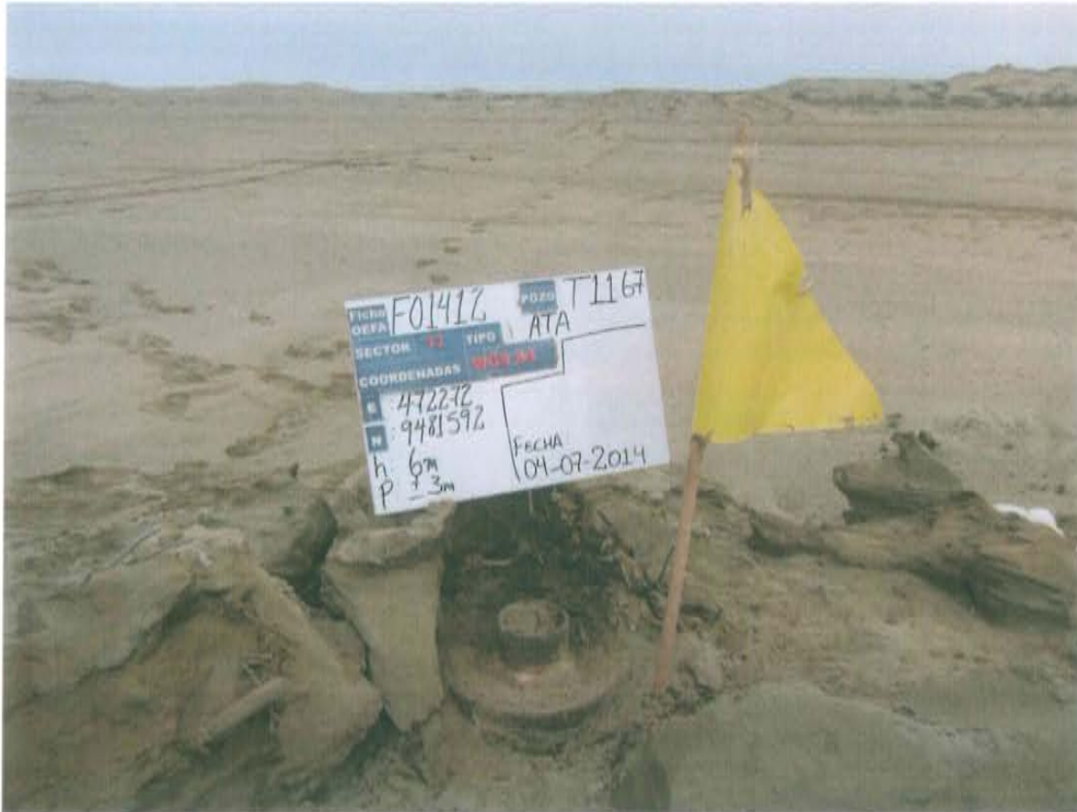
Fotografía N° 1. Se observa que el Pozo T1167, presenta tubería de reducción abierta y expuesta al ambiente.
