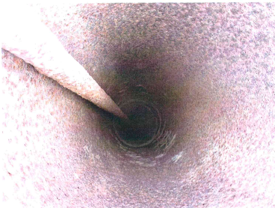
Fotografía N° 3. Del interior del hoyo sobresale una varilla corrugada de acero, la cual se observa corroída así como el interior del casing.
