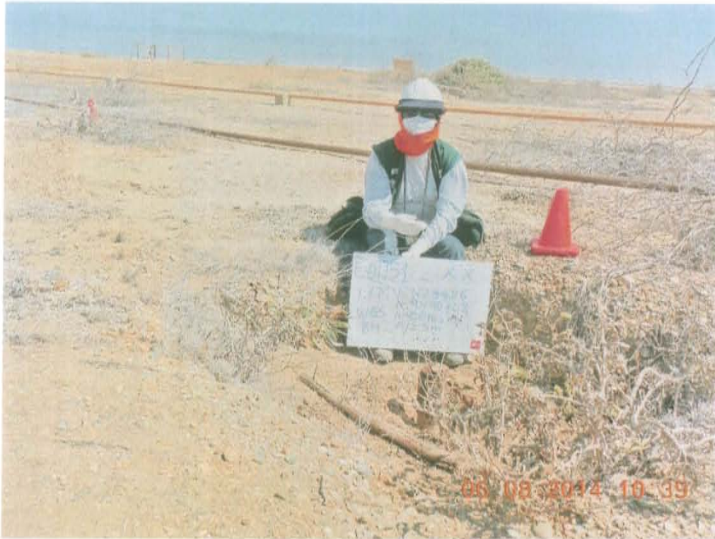
Fotografía N° 1. Pozo inactivo con el casing corroído, se encuentra abierto y expuesto al ambiente.
