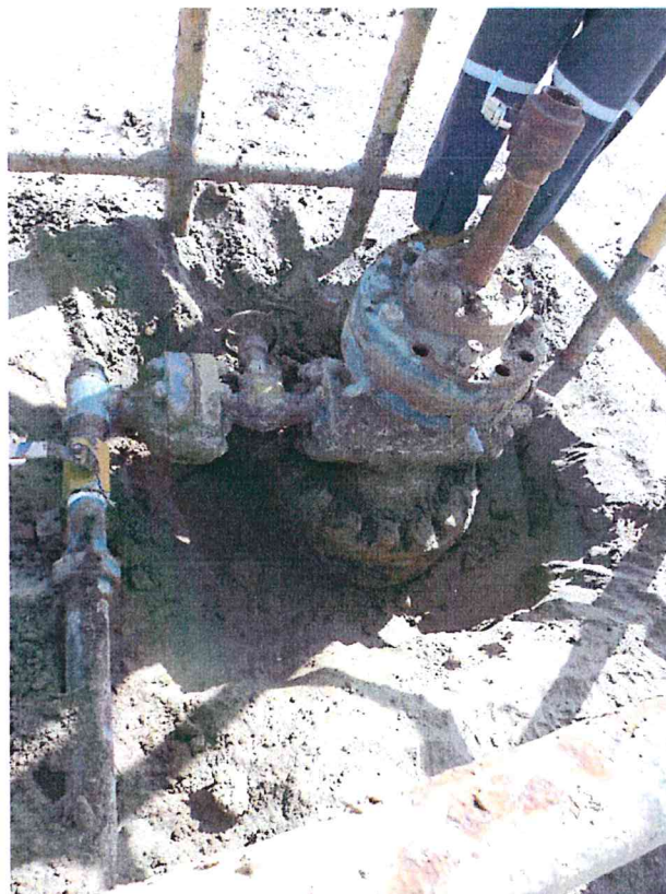
Fotografía N° 3. Cabezal del pozo T4590 conectado a una tubería, ubicado a nivel superficial en el interior de un cerco metálico.
