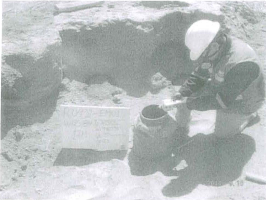
Fotografía N° 1. Medición en el punto F00431-EM01, ubicado en la fuente de emisión en boca del Pozo T1625.
