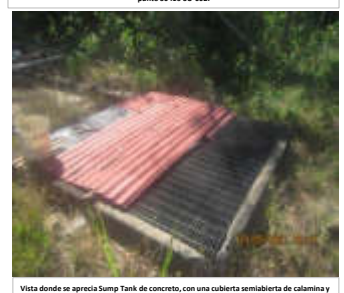
Vista donde se aprecia Pump Tank de concreto, con una cubierta semibierta de calamina y rejilla metálicas, está asociado a los pozos DORI-10 y DORI-11.
