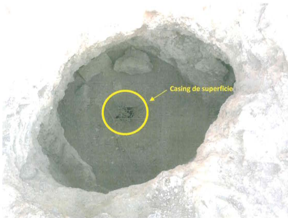
Fotografía N° 2. Vista del interior del hoyo donde se ubica el Pozo T3137 donde se observa la presencia de restos de concreto y el casing cubierto por pequeñas ramas.
