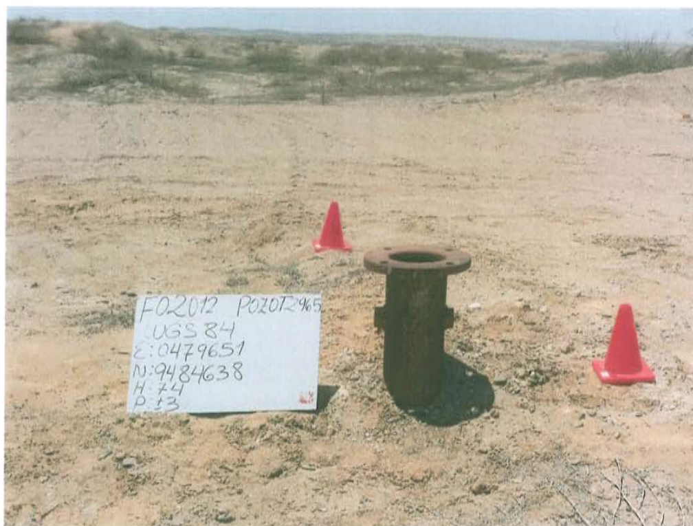
Fotografía N° 1. Pozo T2965, presenta casing abierto al ambiente a nivel de la superficie del suelo.
