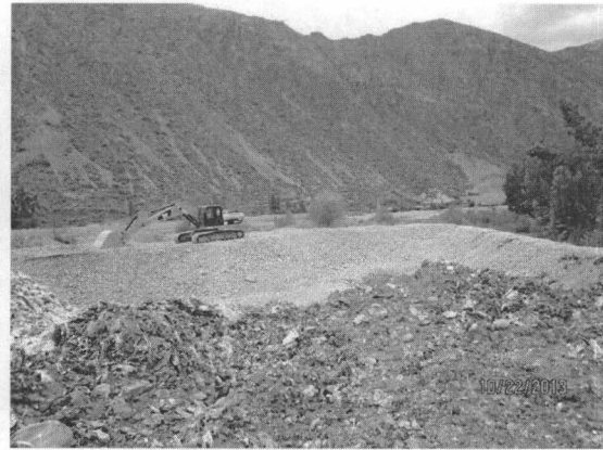
Foto 26: Celda sin impermeabilizar construida por la pala mecánica donde se disponen los residuos
