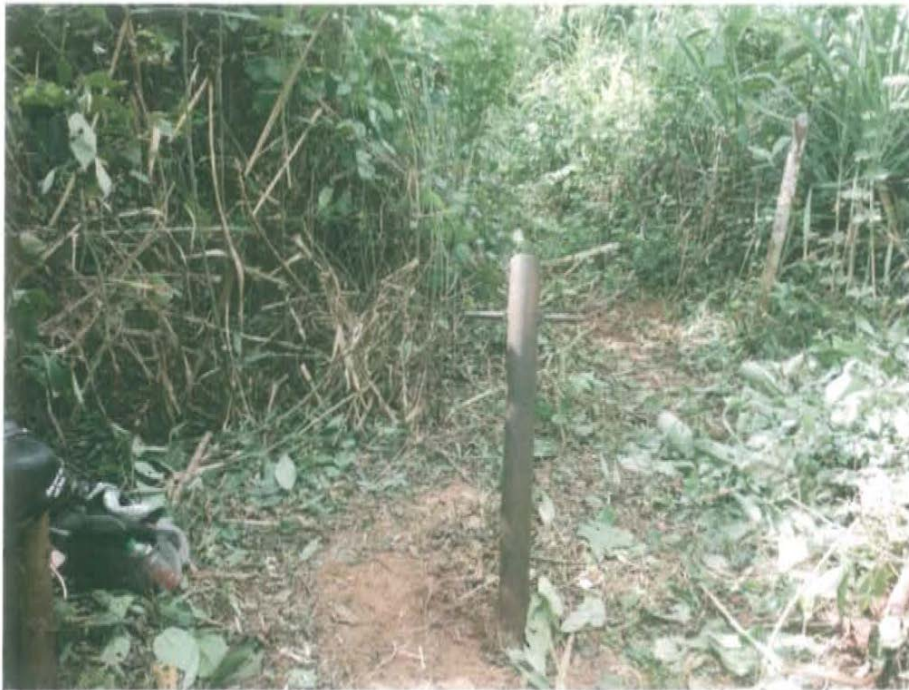
Fotografía N° 1. Vista donde se observa la tubería de revestimiento inclinado sin cabezal y expuesto al ambiente.
