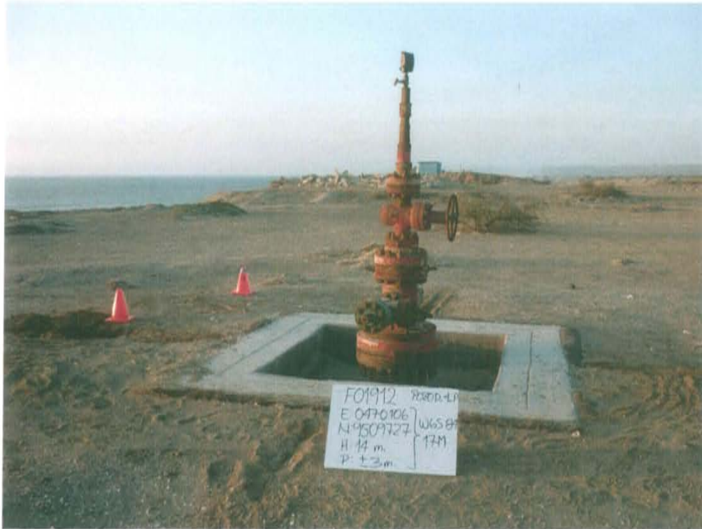
Fotografía N° 1. Identificación del pozo inactivo con código PERUPETRO D_4_P. Presenta cabezal oxidado.
