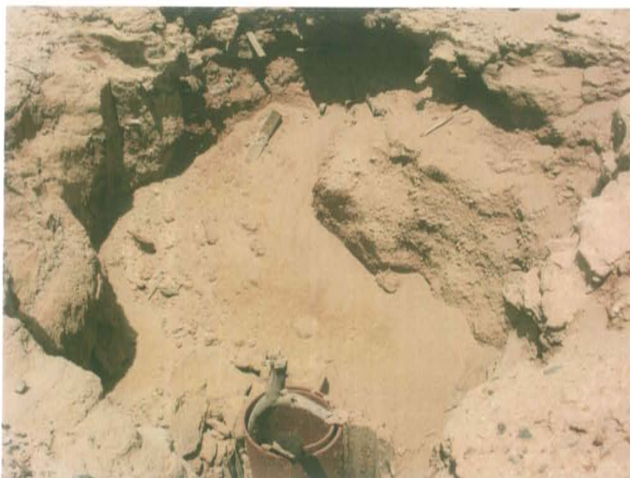
Fotografía N° 1. El pozo presenta doble casing no cementado, corroído, abierto sin ningún elemento de cierre y expuesto 0.2 m sobre la base de un hoyo
