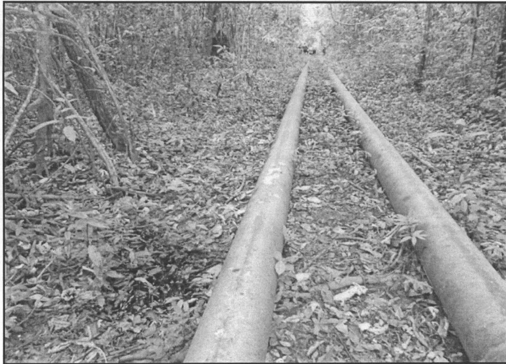
Figura N° 2. La tubería cortada pertenece al oleoducto Corrientes-Saramuro del Lote 8; el ingreso a la zona es bastante hinospito debido a que el terreno es inundable.
