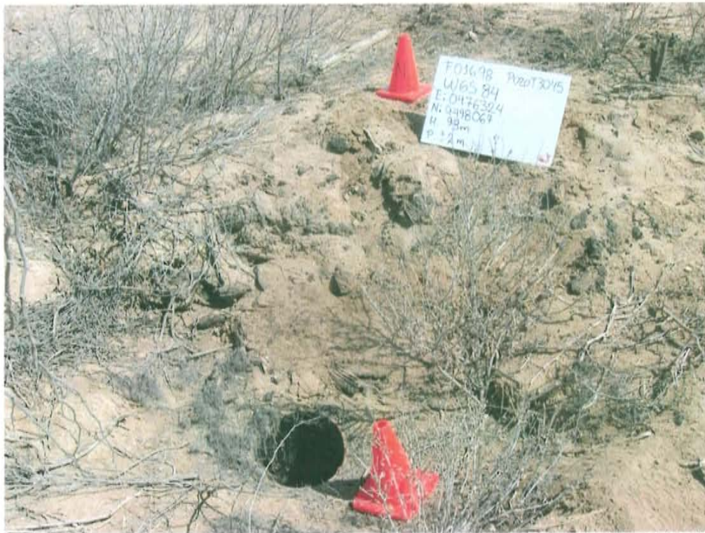
Fotografía N° 1. Identificación del pozo inactivo con código PERUPETRO T3045. Presenta casing sin válvulas que aseguren su hermetismo.
