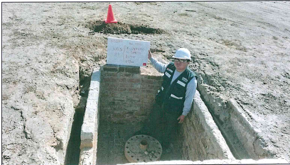
Fotografía N° 1. Vista del Pozo T5106, casing con cabezal incompleto y sin válvula que asegure su hermetismo.
