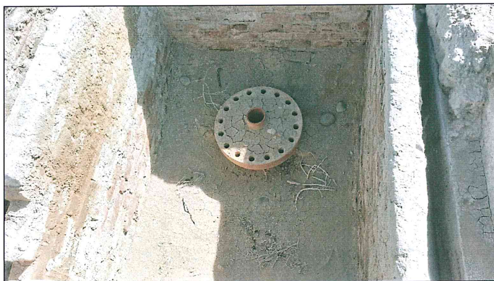
Fotografía N° 3. Ubicación del casing dentro de la cantina en deterioro conformada por ladrillos con 1,2 m de profundidad.
