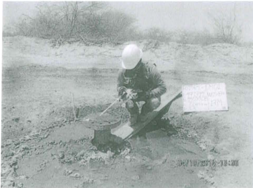
Fotografía N° 1. Medición en el punto F01564-EM01, ubicado en la boca del pozo.
