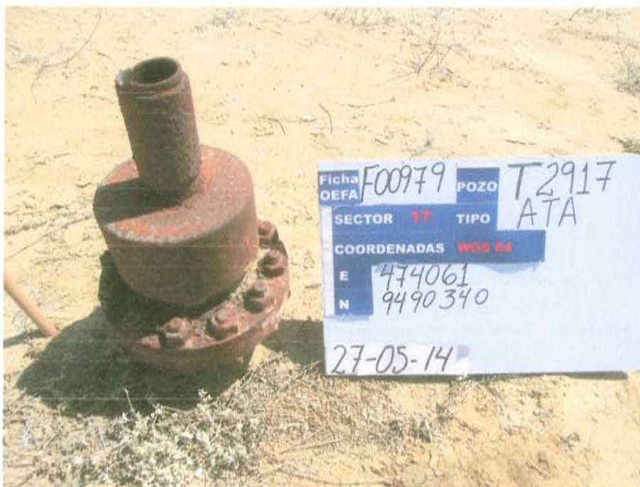
Fotografía N° 1. El Pozo T2917 presenta un casing corroído con prolongación de tubería abierta sobre el cabezal
