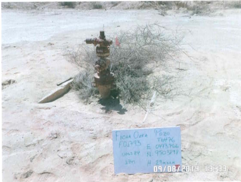
Fotografía N° 1. Identificación del pozo inactivo con código PERUPETRO T6476. Presenta casing con válvulas y bridas.
