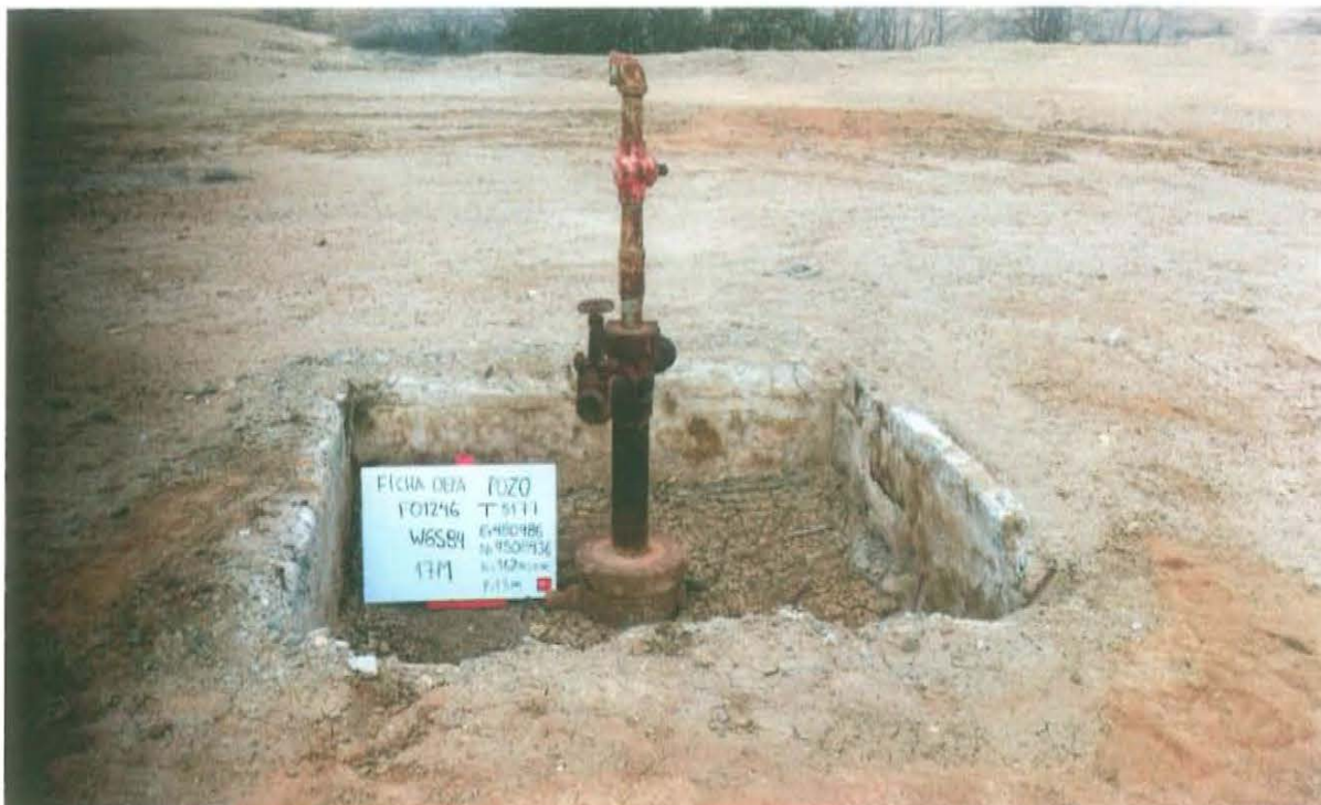
Fotografía N° 1. Pozo con código Ficha OEFA F01246 y con código PERUPETRO T5177, se puede apreciar el casing dentro de una cantina deteriorada, unido a un cabezal con claros signos de corrosión por lo que no se asegura su hermetismo.
