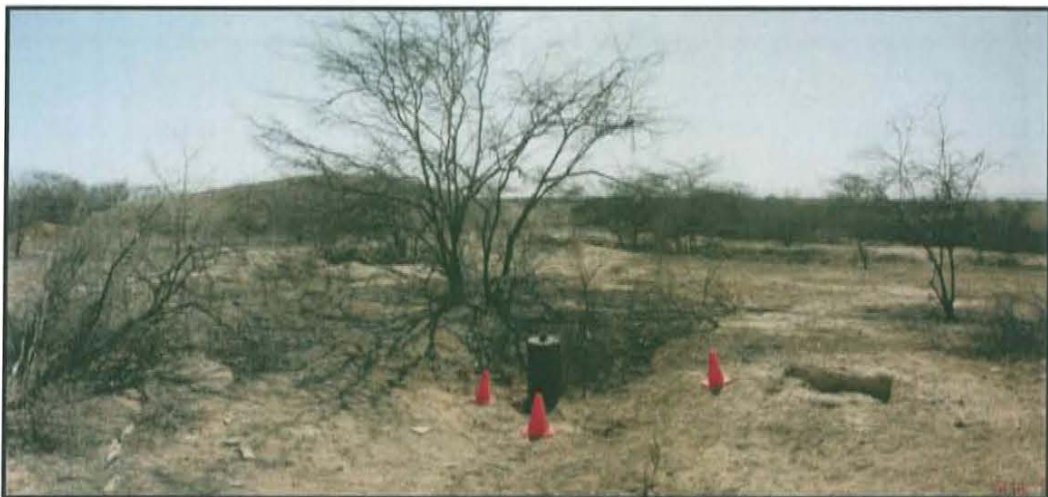
Fotografía N° 2. Parte superior del pozo, se puede observar tubo de reducción de 2 plg abierto y expuesto al ambiente.
