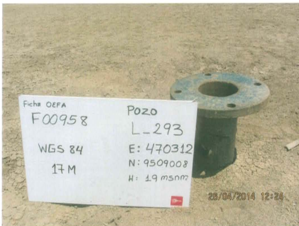
Fotografía N° 1. Se observa cabezal del pozo que se encuentra abierto al ambiente.
