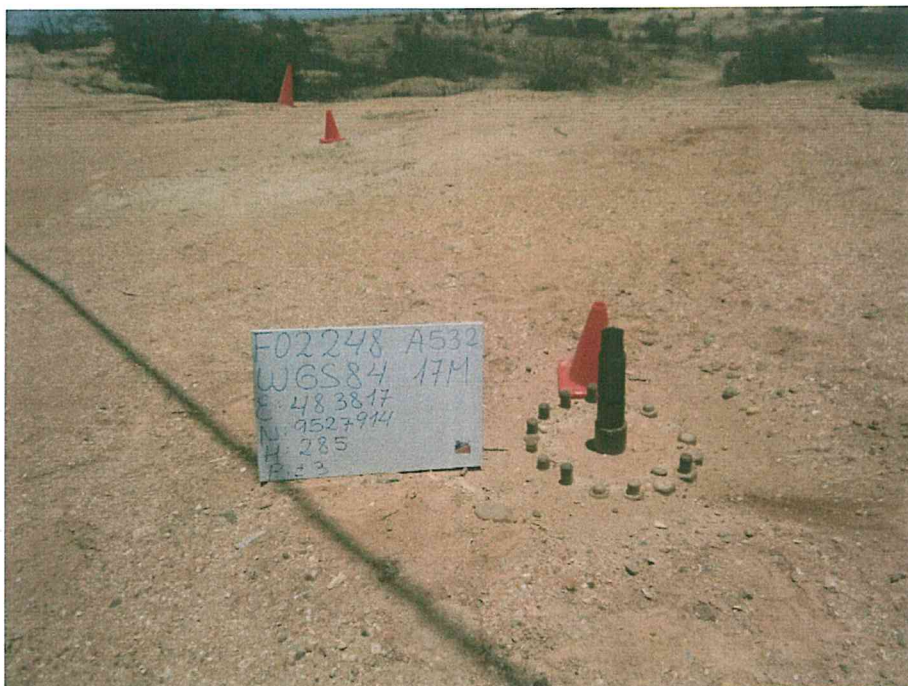
Fotografía N° 1. Pozo inactivo (A532) ubicado en un terreno no habilitado con casing y brida enterrada con visibles signos de corrosión.
