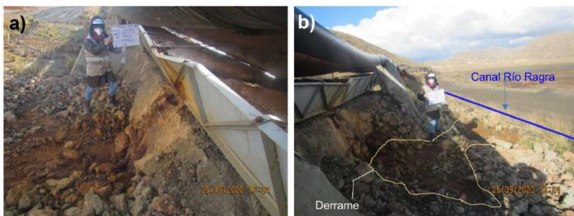
Figura 7.35. a) Canal de contención colmatado y b) prolongación de derrame en dirección a la canalización del río Ragra
